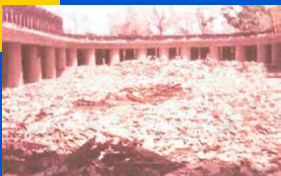
Ruines des structures de la toiture détruite par un obus incendiaire en 1981.
